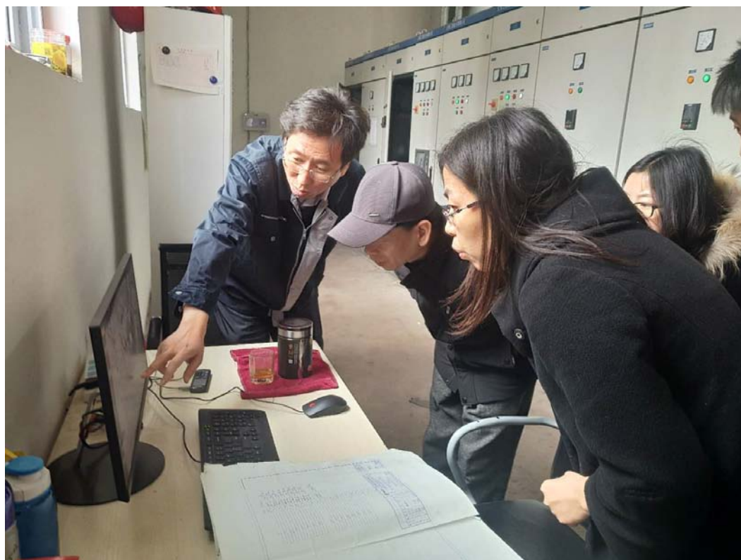
图 2-冲渣水余热利用配电室现场
